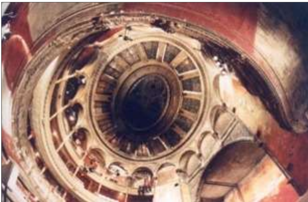
Obr. 12. Vysoký strop Bouffes du Nord. Kopule vytváří atmosféru a podporuje akustické vlastnosti prostoru.
